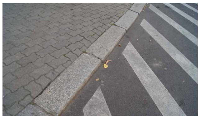
Nicht vollständig abgesenkter Bordstein in Mitte
